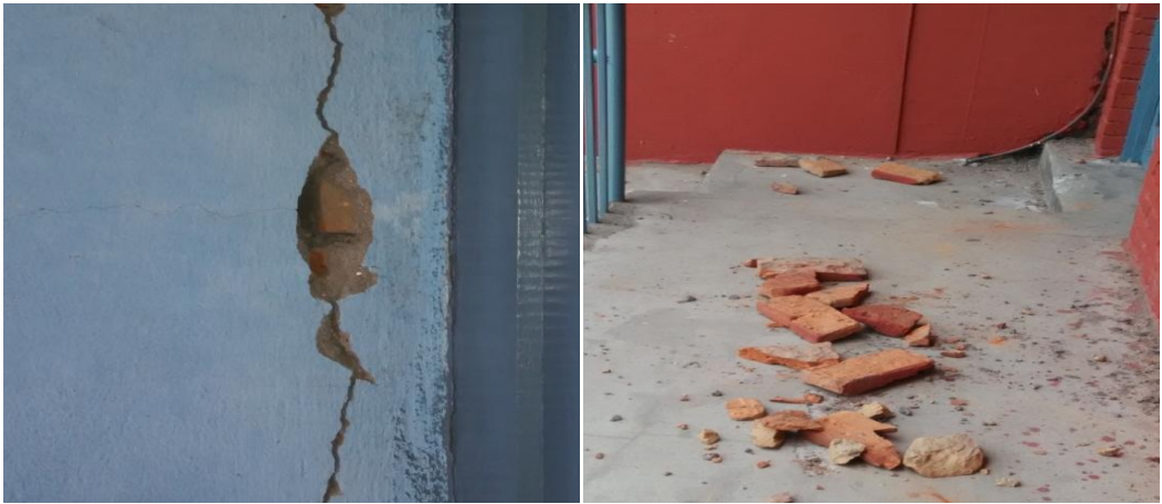
職業訓練所のひび割れ
