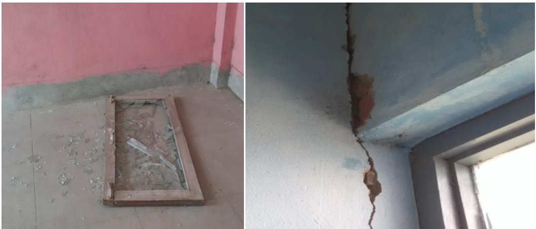
教室の落ちた窓と壁のひび割れ
