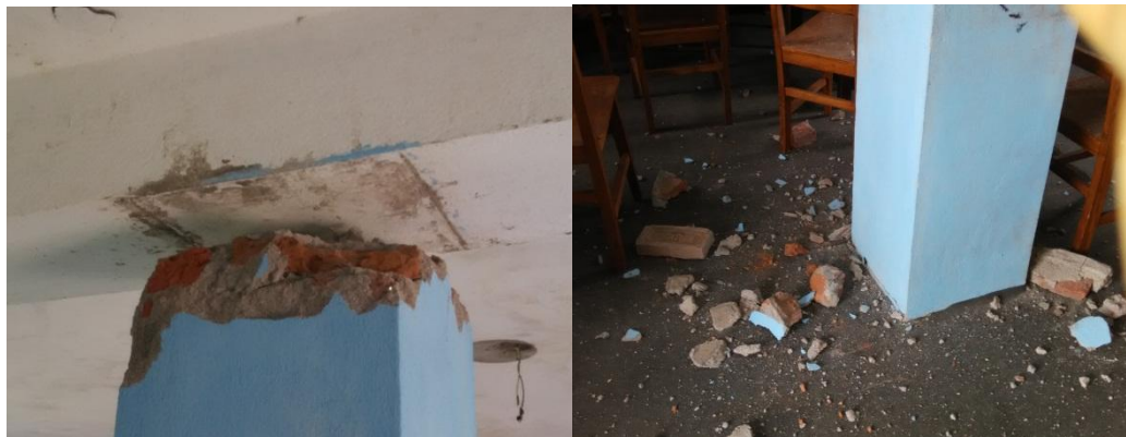
図書室の柱の損害
