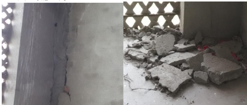
ダルマスタリ寄宿舎の損害状況
