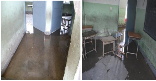
学校1階に溜まる地下水
