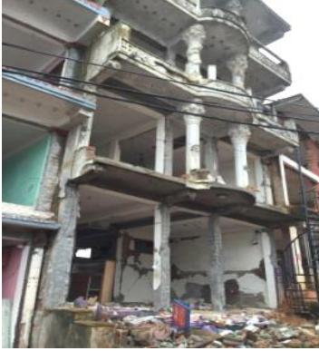
被災した建物
