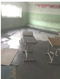
浸水した教室
