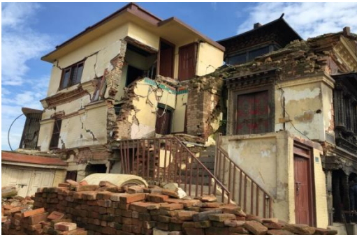
角地にある壊れた古い建物
